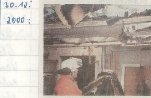
Sachschaden in Höhe von mehreren hunderttausend Mark richtete gestern Morgen ein Feuer in der Grüninger Schreinerei
